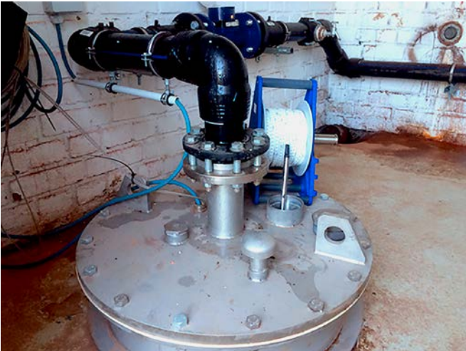
Abb. 5: Pegelmessung mittels Lichtlot über die Brunnenkopfföffnung
